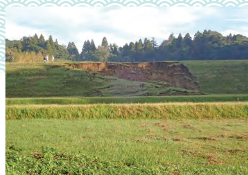
着工前(被災状況)
